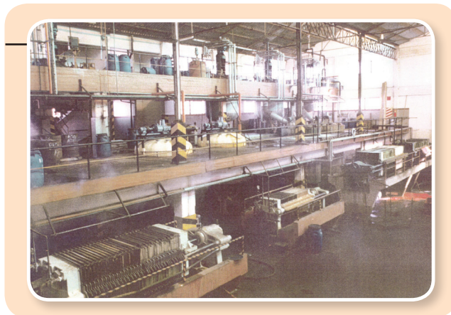
Figura 2: Vista de equipos e instalaciones de producción de colorantes de Anilinas Argentinas SA
